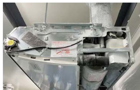
空調機内部まで粉が侵入
