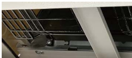
空調機内部の粉体の付着は ごくわずか ※空調機稼働条件:24時間、365日
