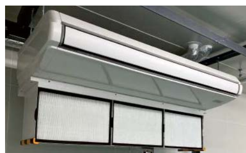
天井吊形エアコン (FXYP112NA) + パウダーガードフィルタ 設置前に空調機内部を洗浄し、 パウダーガードフィルタを設置し、5カ月使用
