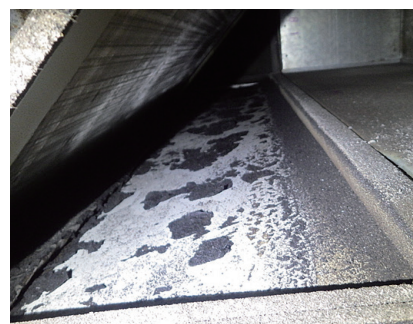
空調機内部に粉体が蓄積 ▶
