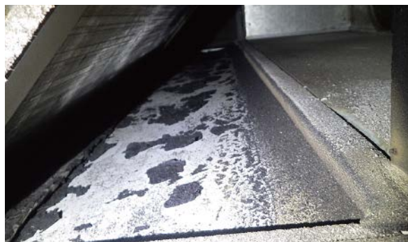
空調機内部に粉体が蓄積
